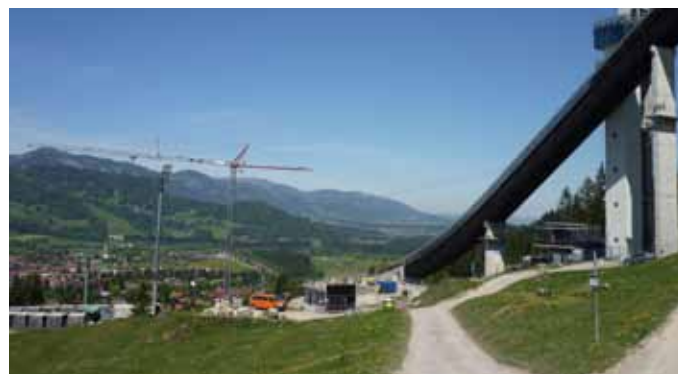
Aus HS 100 wird HS 106: Der Umbau in der Erdinger-Arena ist im Gang.
